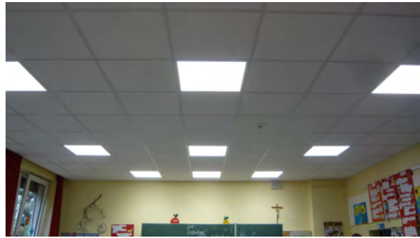
Neue, energiesparende LED-Deckenleuchten
